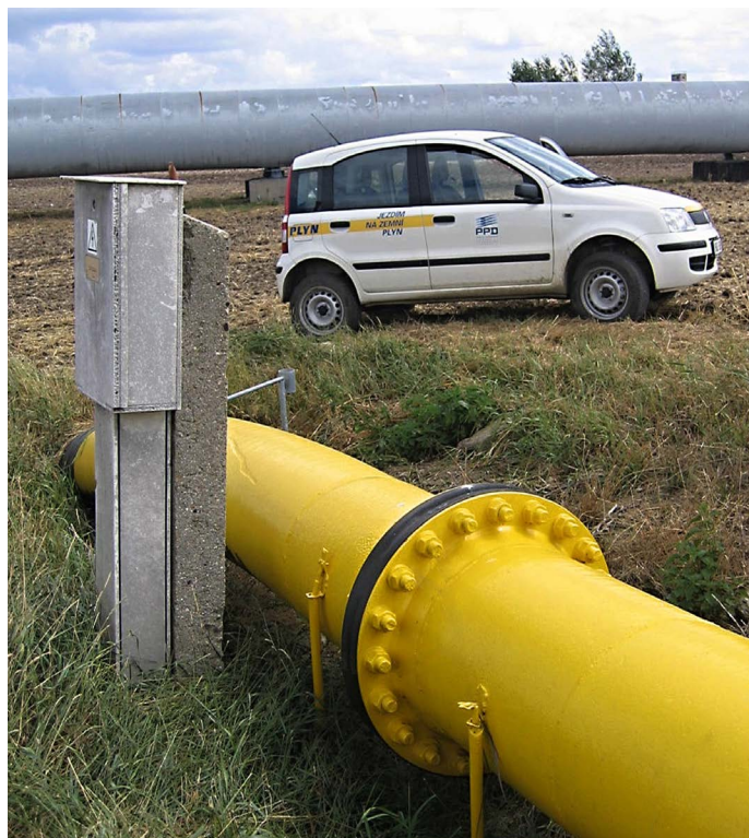
Obr. 2 – nadzemní izolační spoj přírubový a propojovací objekt IS - POIS
