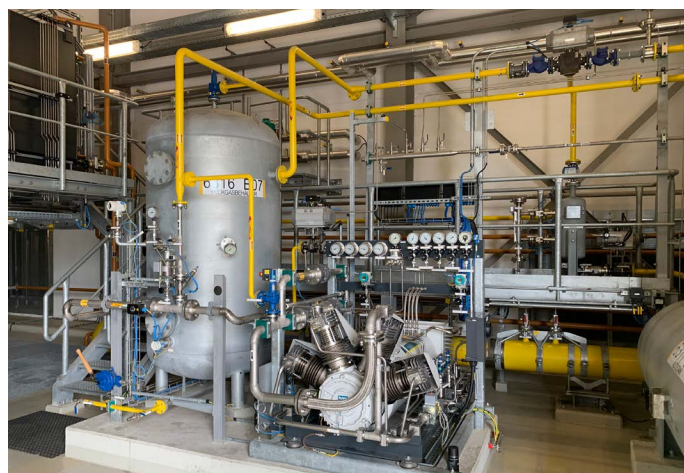
Obrázek 2 – Fotografie ERU s akumulární nádrží
